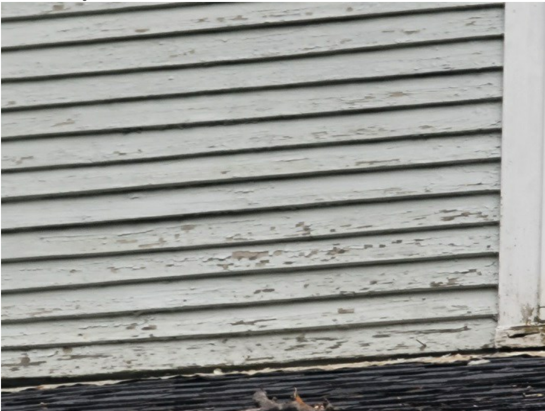
4Exterior Wall Hazard
