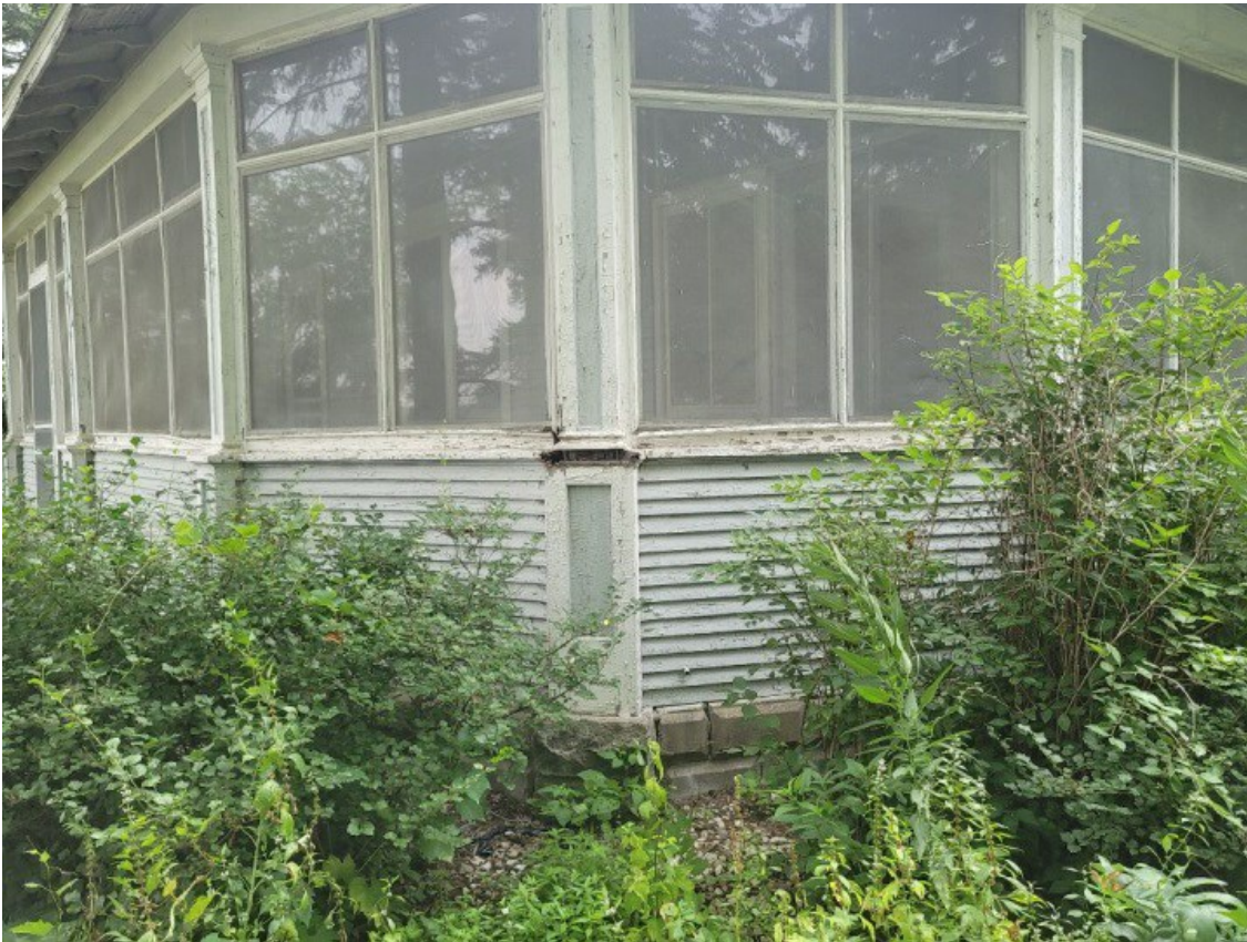
9Exterior Wall Hazard
