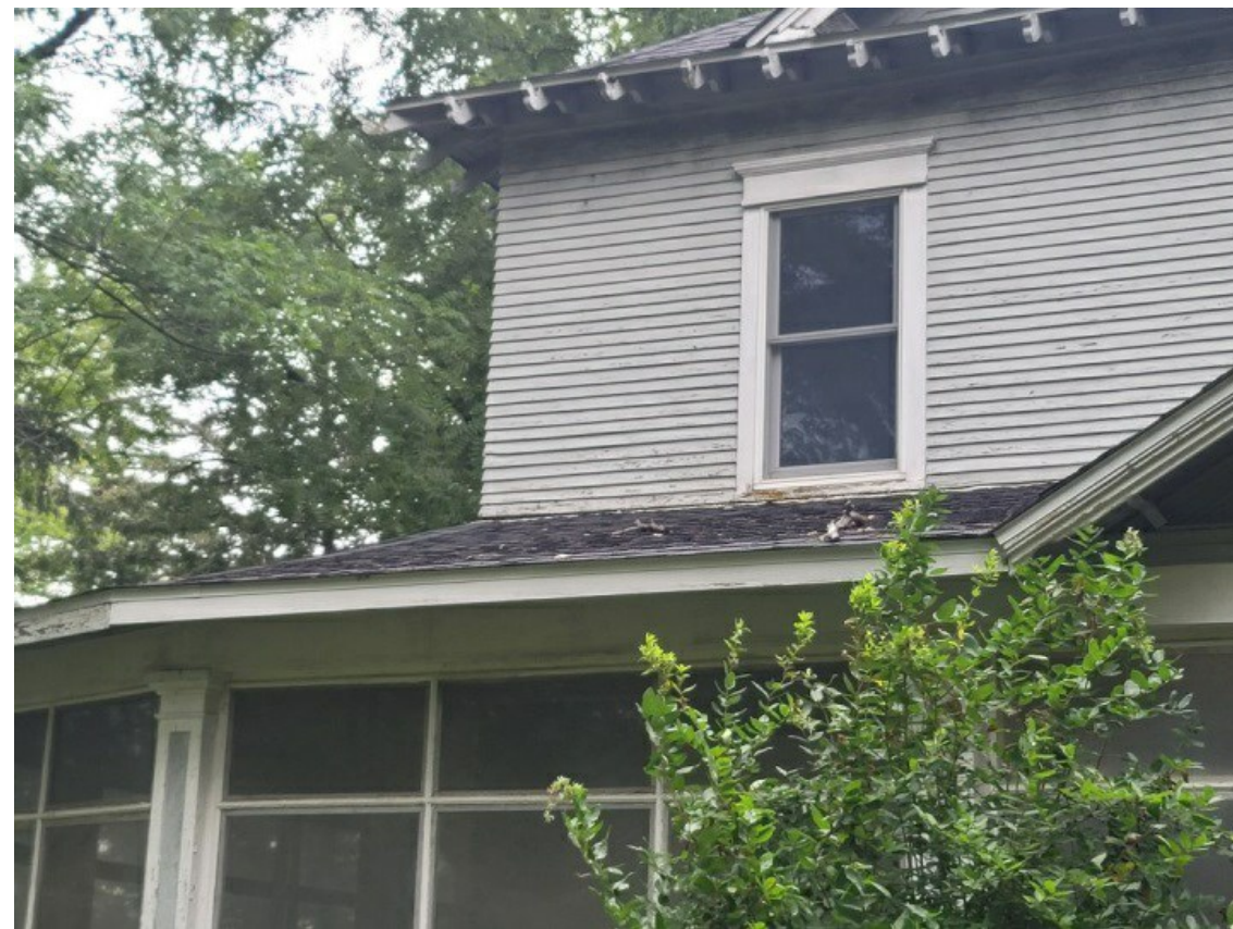
5Exterior Wall Hazard
